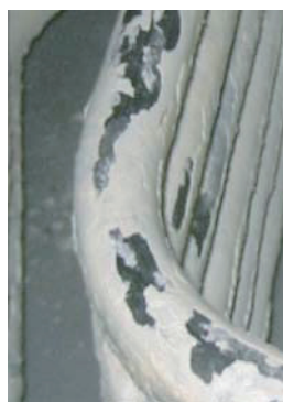
すすぎ槽の熱交換器。 スケールがびっしり
